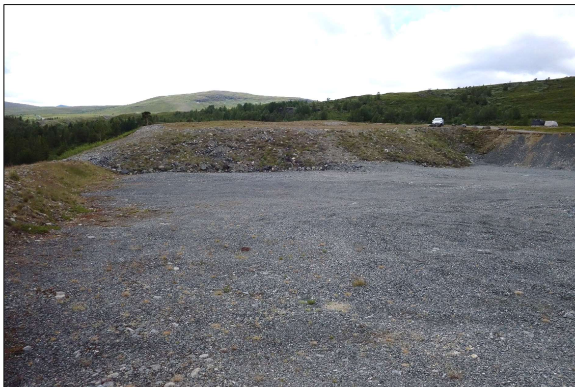
Illustrasjon 10. Det permanente massedeponiet etter kraftutbygginga på søraustre del av Kyrkjeflaten (i bakgrunnen av bildet), er lagt opp til same høgde som tilkomstvegen inn frå Veodalsvegen. Flata i framgrunnen er lager av massar frå kraftutbygginga for uttak og bruk på veganlegget. Massane her består av sprengstein som er dekt over med eit gruslag for tryggleik/tilkomst (foto Ø. Pedersen 2024).
